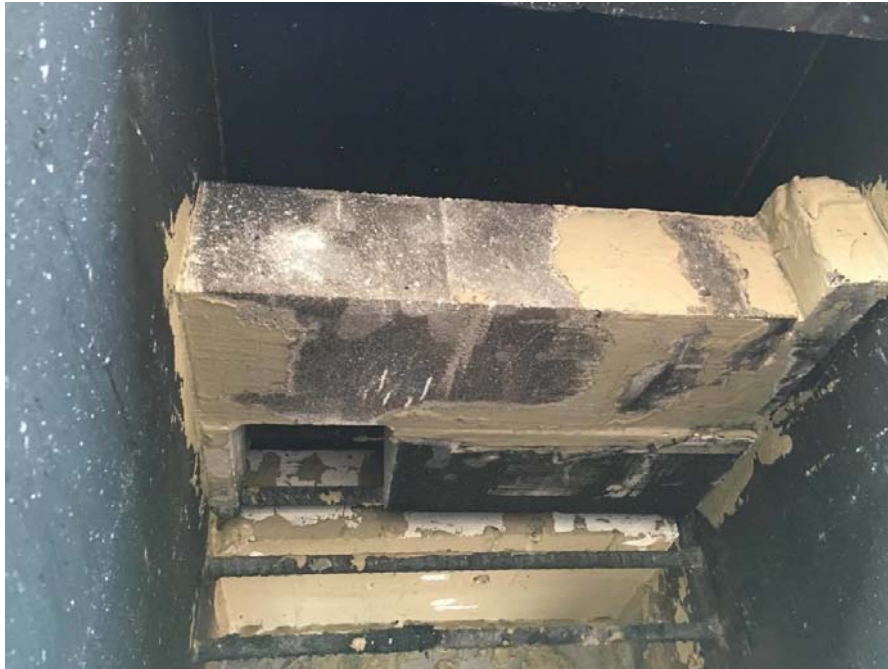
รูปที่ 4.24 ลักษณะการก่อนอิฐทนไฟเป็นผนังกันลมในห้องเผาไหม้ที่ 1 โดยเว้นช่องให้อากาศผ่านไปยังห้องเผาไหม้ที่ 2
