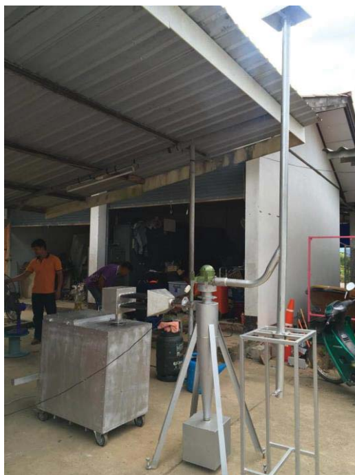
รูปที่ 4.11 ระบบบำบัดก๊าซไอเสียจากเตาเผาขยะได้รับการทดลองและปรับปรุงระบบ
