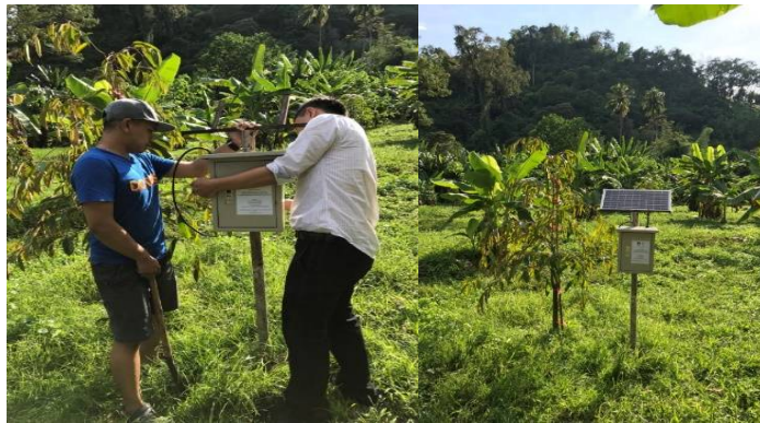
ภาพที่ 4.49 การติดตั้งอุปกรณ์ตรวจวัดสภาพแวดล้อมในเขตพื้นที่หมู่ 3 บ้านต้นเกลือ ตำบลแม่พูล อำเภอลับแล จังหวัดอุตรดิตถ์
