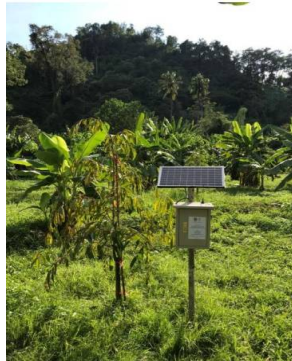
ภาพที่ 4.45 การติดตั้งอุปกรณ์สถานีย่อยภายในพื้นที่ทดสอบ
