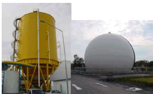
ภาพที่ 2-9 : ถังย่อยสลายแบบไม่ใช้ออกซิเจน และถังเก็บก๊าซชีวภาพโครงการผลิตปุ๋ยอินทรีย์และพลังงานเทศบาลนครระยอง จังหวัดระยอง ที่มา : www.dede.go.th
