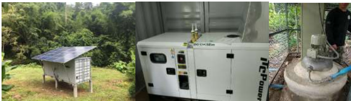
ภาพที่ 10: แผงโซลาร์เซลล์และเครื่องผลิตกระแสไฟฟ้าพลังงานน้ำ
